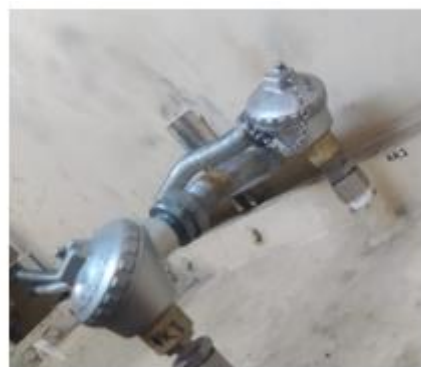
Gambar 4. 1 Gambar RTD PT100 yang terpasang di Air Cooler Generator PLTA (By Rahmad)
